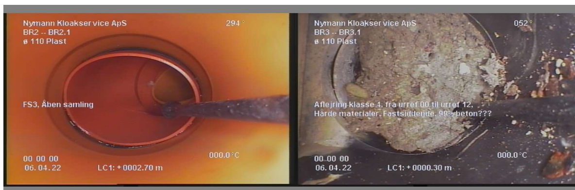
Utæt og klemt rør
